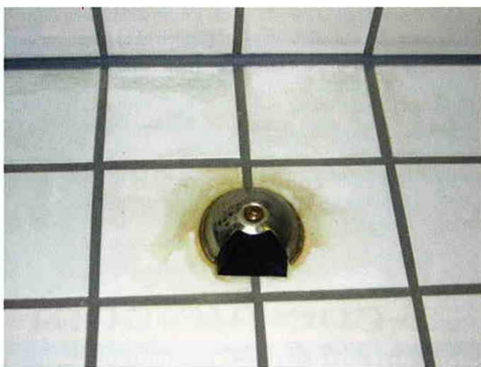
Rostbefall an einem Türstopper aus Edelstahl. Typischer Nachweis für den unangebrachten Einsatz von einem zu aggressiven, salzsäurehaltigen Reinigungsmittel.
